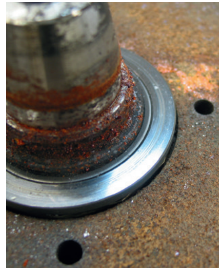
Bozulmuş keçe - çalışma yüzeyi yabancı partiküller nedeniyle tahrip olmuş
